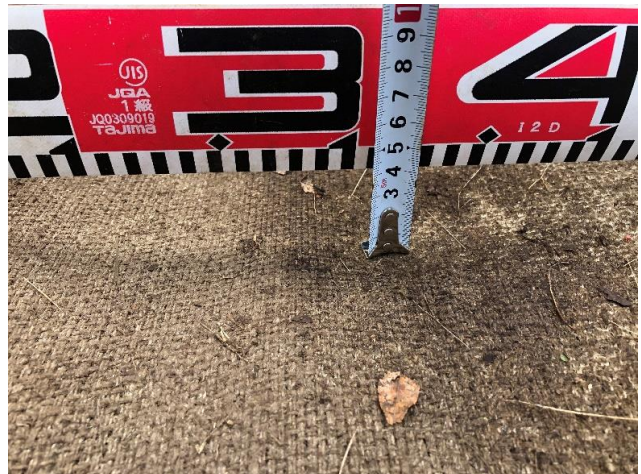
④ モニタリングポイント(洗掘高)
